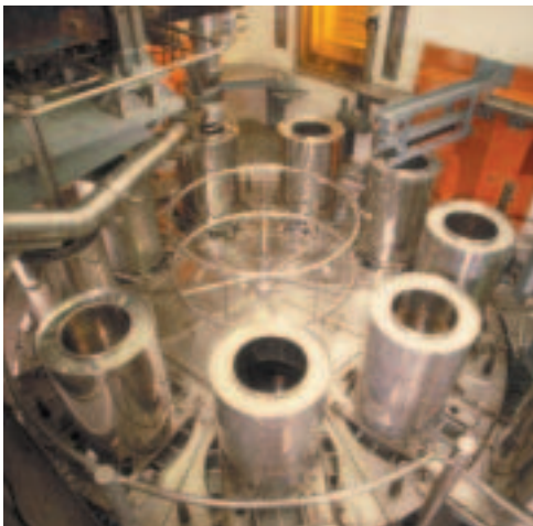
Drum filling carousel. STE 3 effluent treatment station (COGEMA La Hague)
