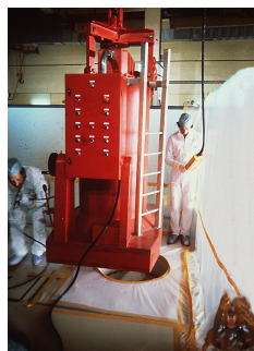
Puits d'entreposage et hotte de manutention
