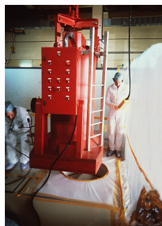
Puits d'entreposage et hotte de manutention
