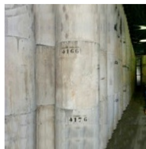
Coques béton contenant des fûts métalliques de boues et concentrats
