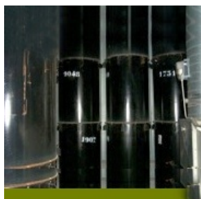
Conteneurs métalliques de concentrats cimentés
