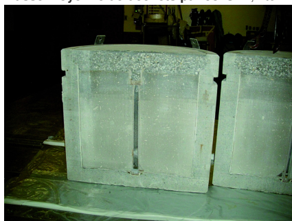
Coupe d'une coque béton pour expertise
