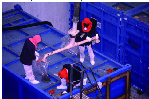
Injection interne d'un rack de Penly
