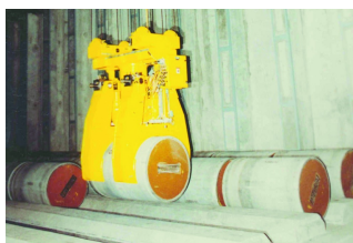
Alvéole d'entreposage des CAC
