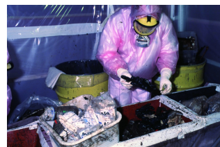
Tri de déchets (Fort d'Aubervilliers)
