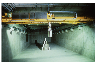
Entreposage des colis d'enrobés bitumineux
