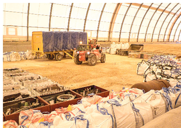
Alvéole de stockage de déchets TFA
