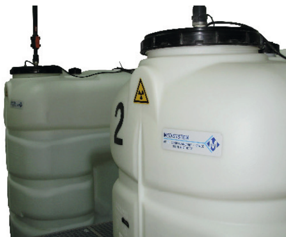
Cuves de décroissance
