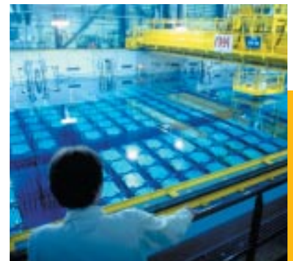
Piscine d'entreposage des combustibles usés. Usine de traitement des combustibles usés COGEMA La Hague
