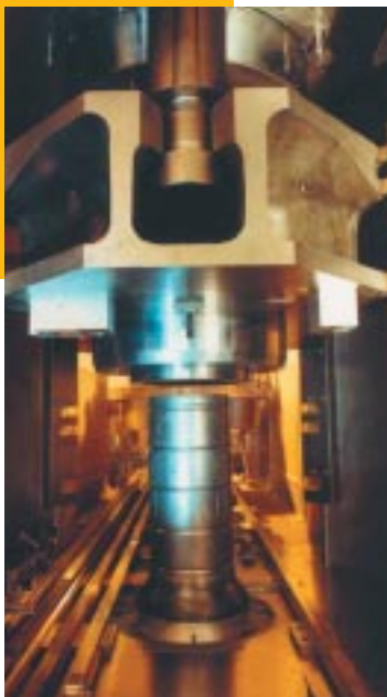
Compactage des déchets (COGEMA La Hague)
